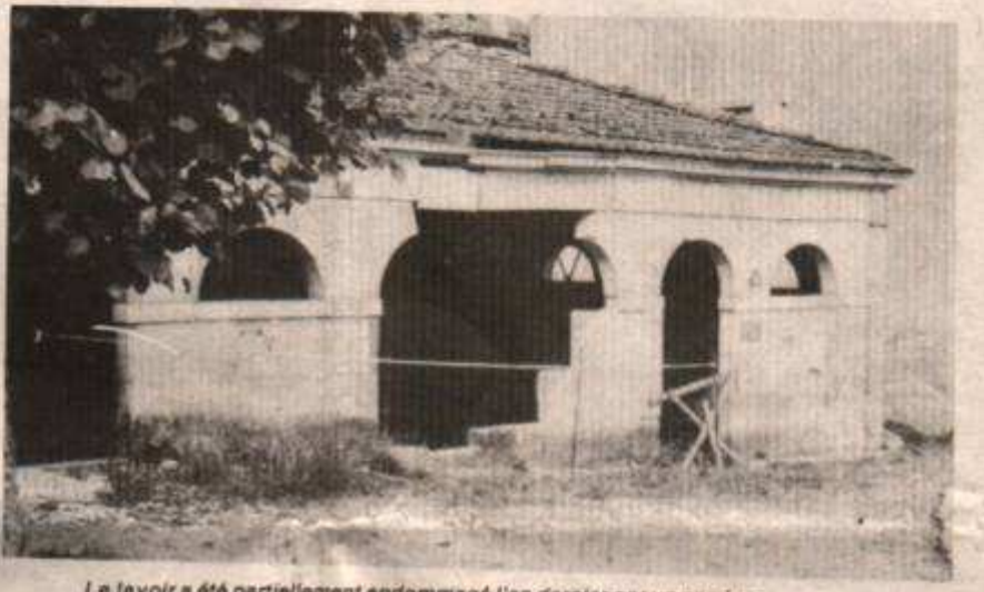
Le lavoir a été partiellement endommagé l'an dernier par une glissade.
